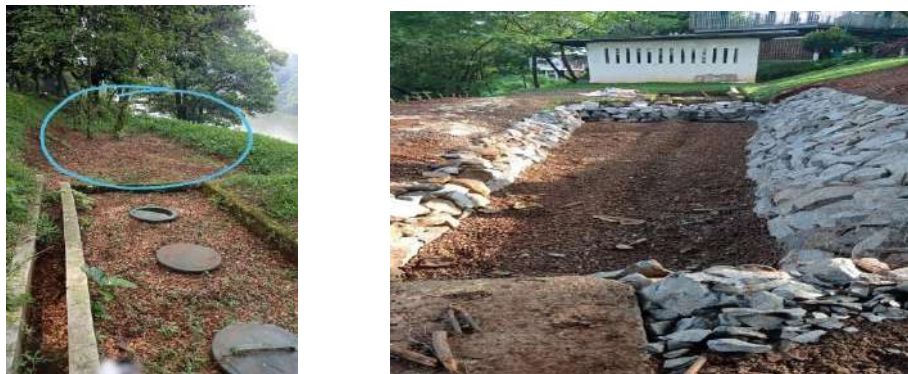
Gambar 34 Instalasi Pengolahan Air Limbah (IPAL)
