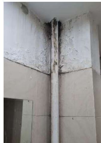
Gambar 198 1) Perbaikan plafon toilet (kiri); 2) Perbaikan lantai toilet (tengah); 3) Perbaikan pipa air bersih (kanan)
