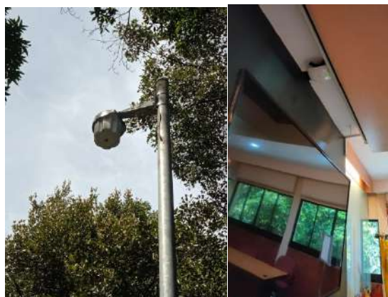
Gambar 36 Pemasangan Hotspot Wi-Fi
