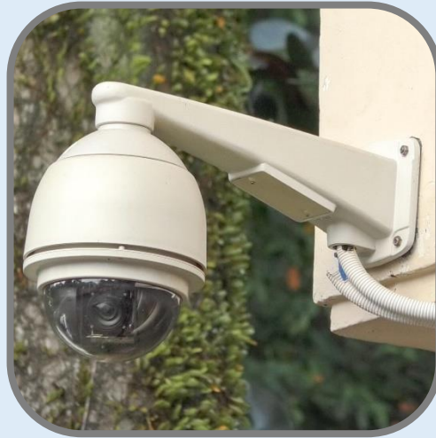
CCTV (di seluruh area kampus dan kelas)
